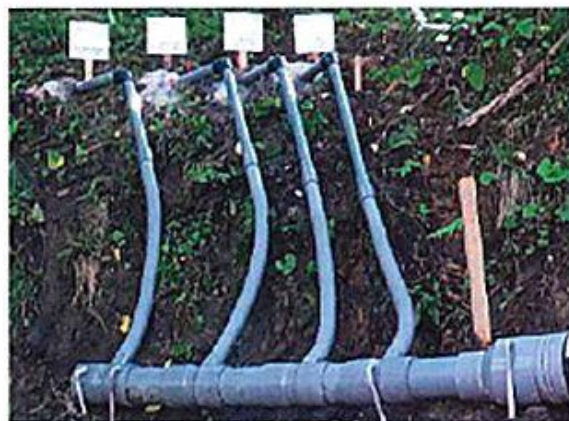
法面に沿わせた配管 法面から雨状に差し込んだボーリング配管を 集合管へ接続する際、フレキシブルで施工が容易
