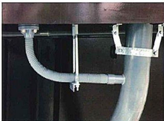
橋梁用床版水抜きパイプとの組み合わせ 融雪剤によるステンフレキの腐食・剥落の改修に
